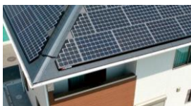
太陽光発電システム
