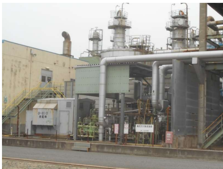
工場内の発電機
