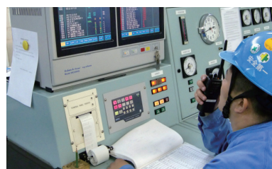
模擬入力による監視装置精度確認 Monitoring accuracy check using dummy signal input
