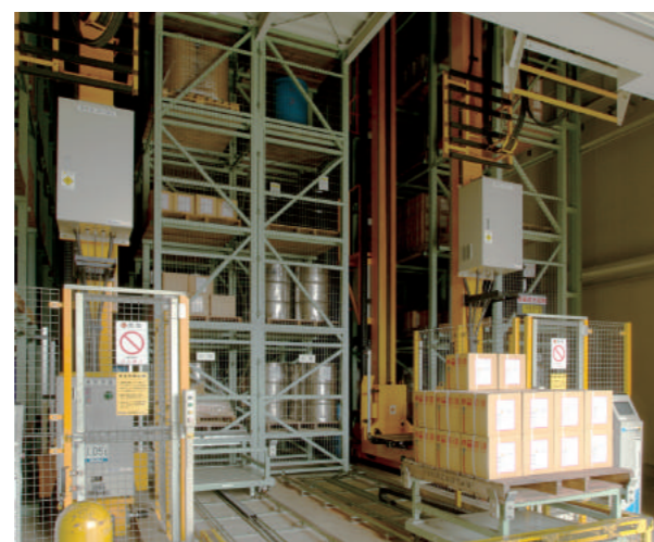
自動倉庫 Automated warehouse
