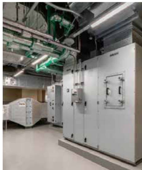
機械設備（空調機）
