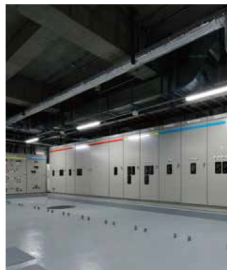
電気設備(特高受変電設備)
