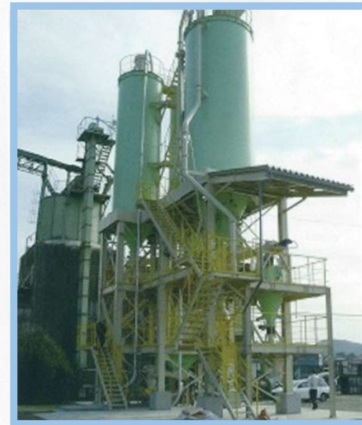
粉粒体混合設備
