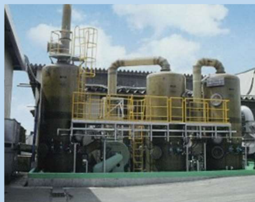
排ガス脱臭装置
