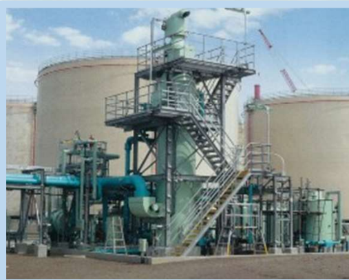
ナフサ脱臭設備
