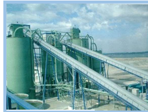
生コン現地製造プラント
