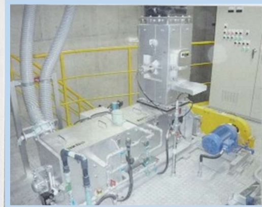
焼却飛灰処理設備
