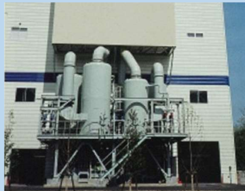
ごみ設備脱臭装置
