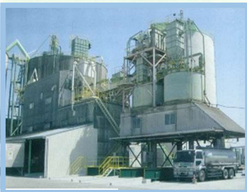
トラック出荷設備
