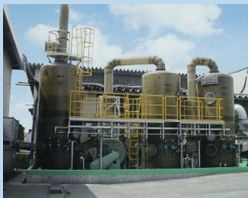
排ガス脱臭装置
