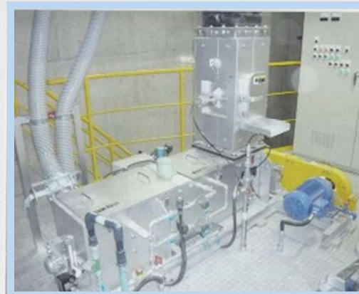
焼却飛灰処理設備
