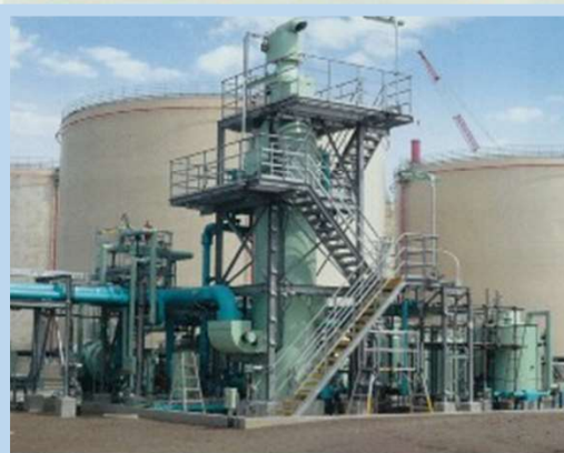
ナフサ脱臭設備
