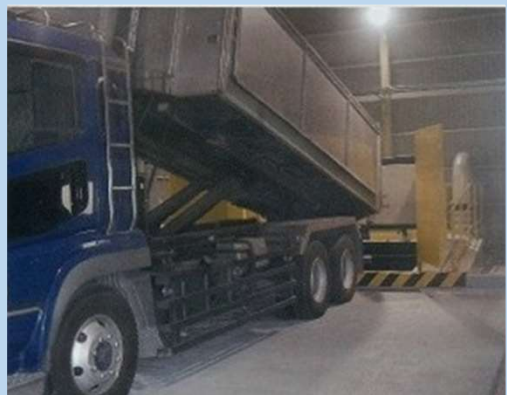
汚泥受入設備
