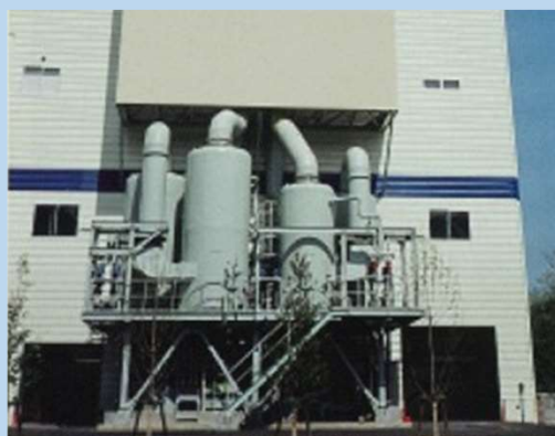
ごみ設備脱臭装置
