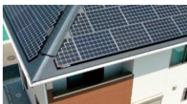
太陽光発電システム
