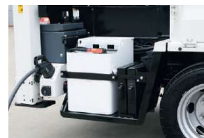
エネルギー密度が高く、コンパクトな「リチウムイオンバッテリー」 ※撮影用にカバーを外しています
