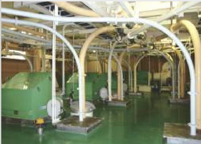
サイロ上供給空気輸送設備
