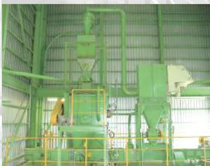
添加混合設備
