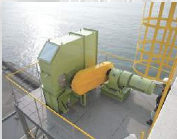
バケットエレベーター
