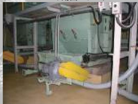
バケットエレベーター残留回収装置
