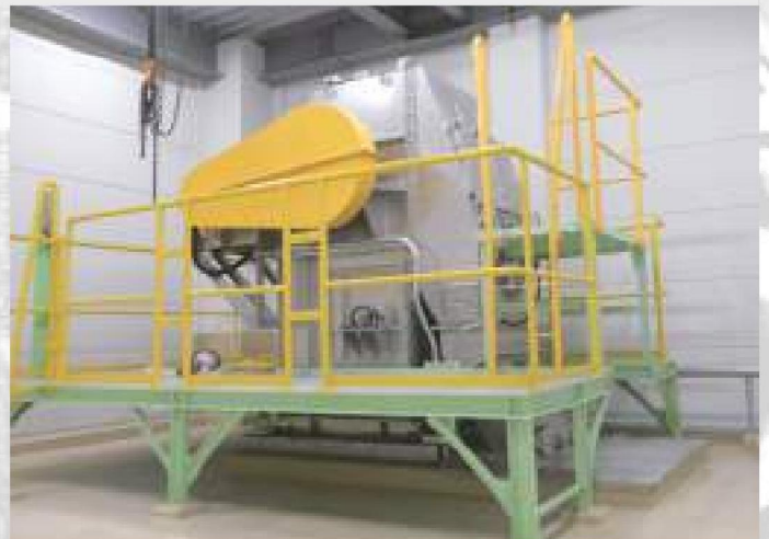
バケットエレベーター
