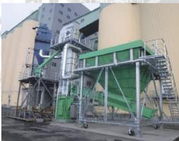
内航船搬入切込設備
