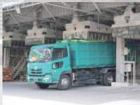
トラック出荷設備(集塵装置付)
