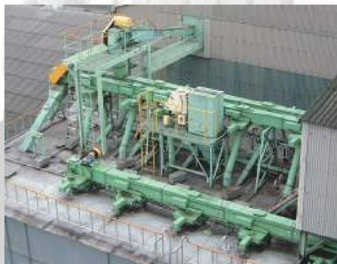
タンク送りコンベヤ
