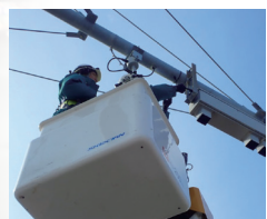
凍結検知装置の点検
