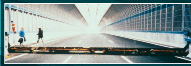
阪神・淡路大震災で路面に生じた段差や隙間 提供：阪神高速道路側
