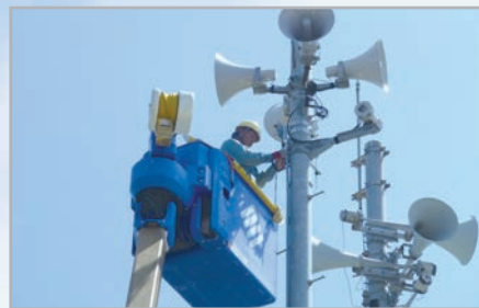
防災無線整備
