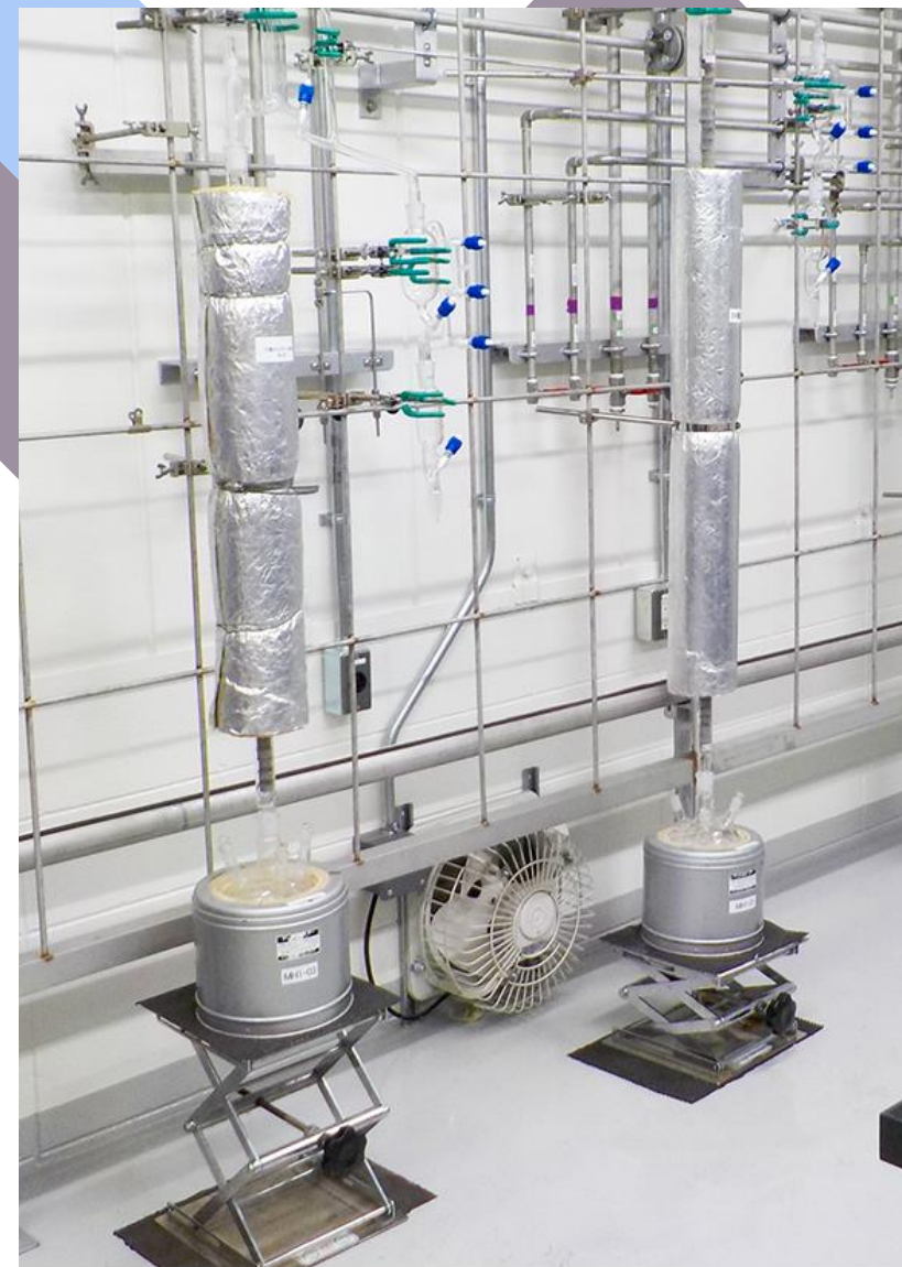
研究・開発用蒸留設備
