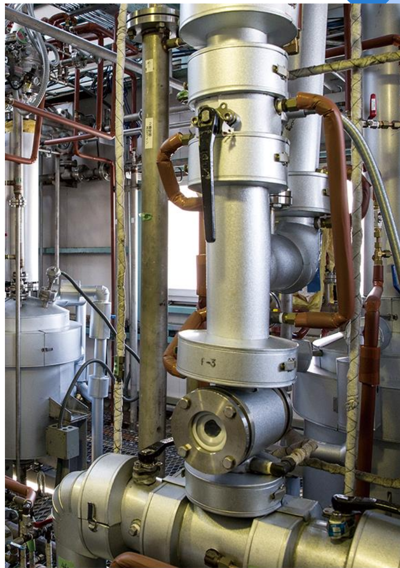
小型蒸留設備
