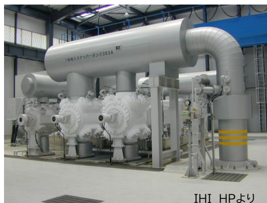
設備メンテナンス (コンプレッサー／ポンプ)
