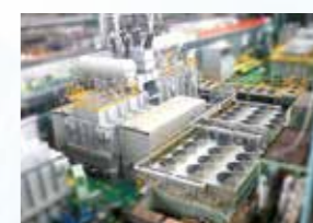
■大容量変圧整流装置
