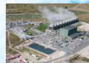
■地熱発電設備
