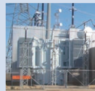
大容量変圧器
