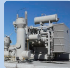
変電システム
