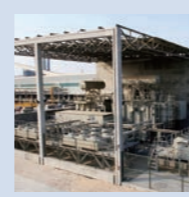
大容量整流設備
