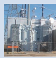
大容量変圧器
