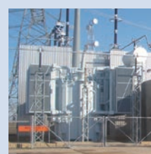
大容量変圧器
