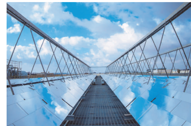
ヨルダンのアンマン工場の屋上に取り付けられた太陽熱集熱設備
