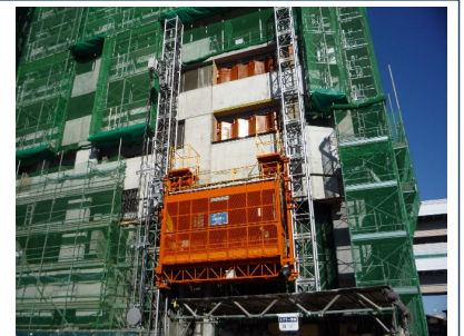
工事用エレベータ
