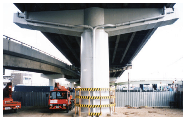
1995年 震災直前に完成した橋脚補強箇所に被害はなかった
