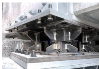
実際に設置された移動制限装置
