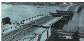
1964年 新潟地震で被災した昭和大橋
