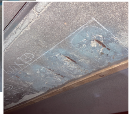
コンクリートはく落状況
