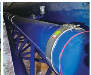
当社カップリングが設置された水管橋
