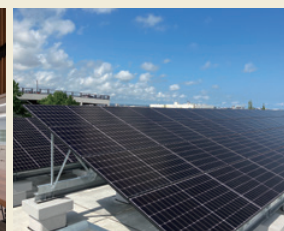
屋上に設置された太陽光パネル
