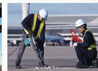
エプロン(不具合補修)
