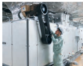
空調設備点検
