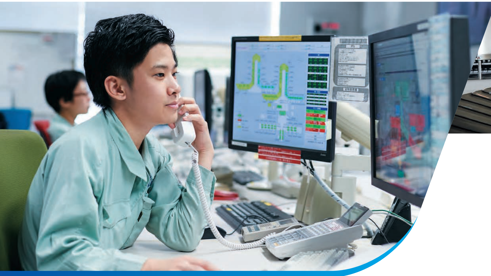
設備集中監視センター
