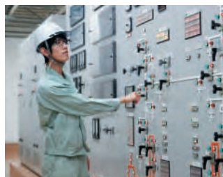
電気設備点検
