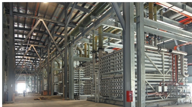
Changi NEWater Plant 規模世界2位、東レのRO膜エレメントを用いた東アジア最大の下水再利用プラント Photo: Sembcorp NEWater Plant, Singapore The world's second largest and East Asia's largest wastewater treatment plant, using Toray RO membrane elements.
